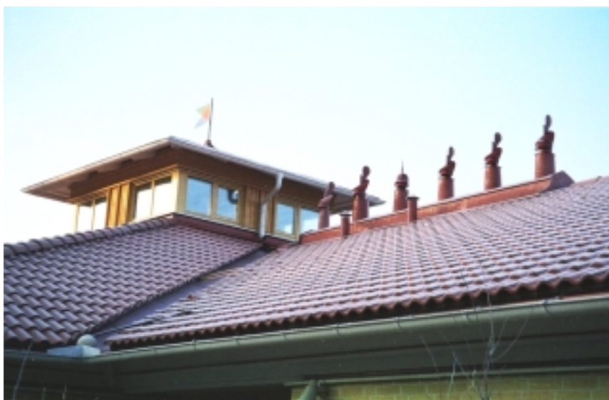
Figur 4.8. Ventilationsafkast på Slättängsskolan i Borås, Sverige
