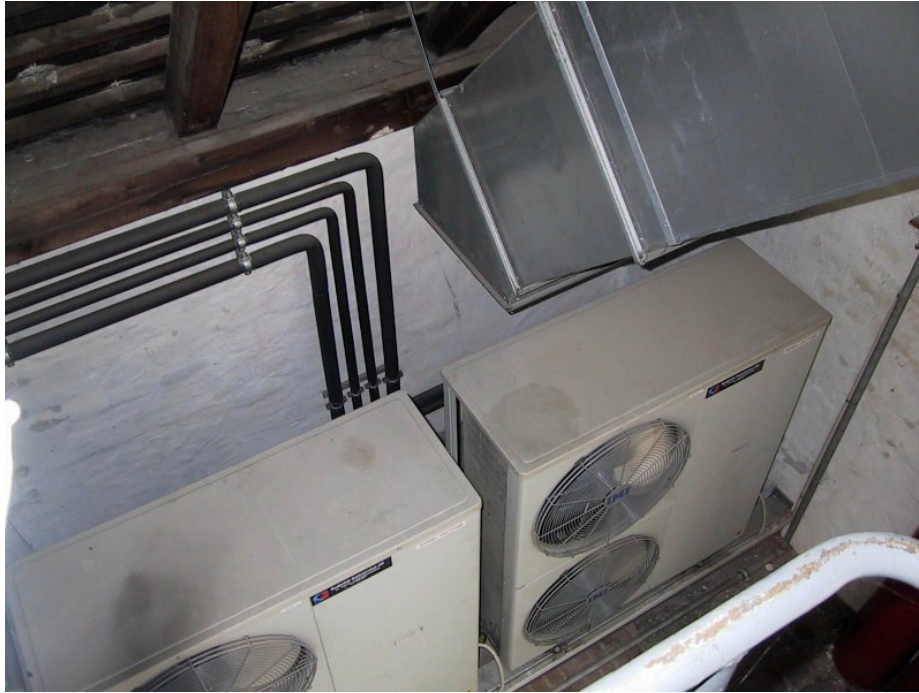
Figur 2.1.5. Køleanlæggenes kondensatorer og kanalen, der leder udeluft til kondensatorerne.
