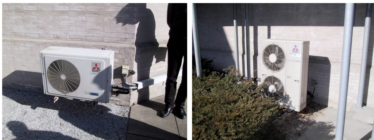
Figur 2.3.3. Køleanlæggenes udedel med kompressor, kondensatorer, m.m.
