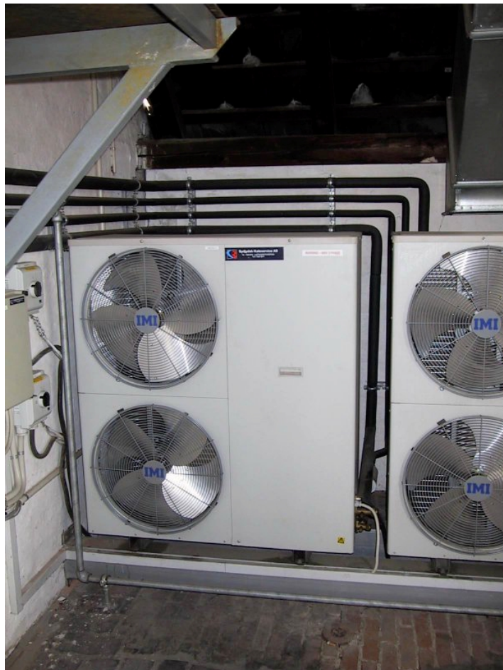
Figur 2.1.4. De to køleanlægs kondensatorer, der servicerer serverrummet.
