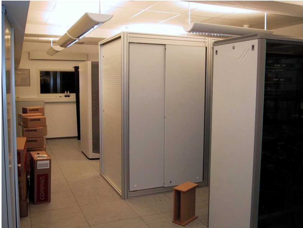
Figur 2.4.2. De tre rack med servere.
