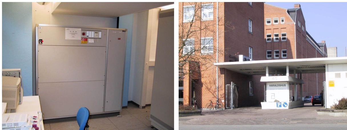
Figur 2.4.3. Det ene køleanlæg i serverrum og varmevekslerne udenfor bygningen.
