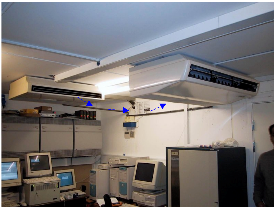
Figur 2.3.2. De to køleanlæg i serverrummet. Vedr. pilene – se senere.
