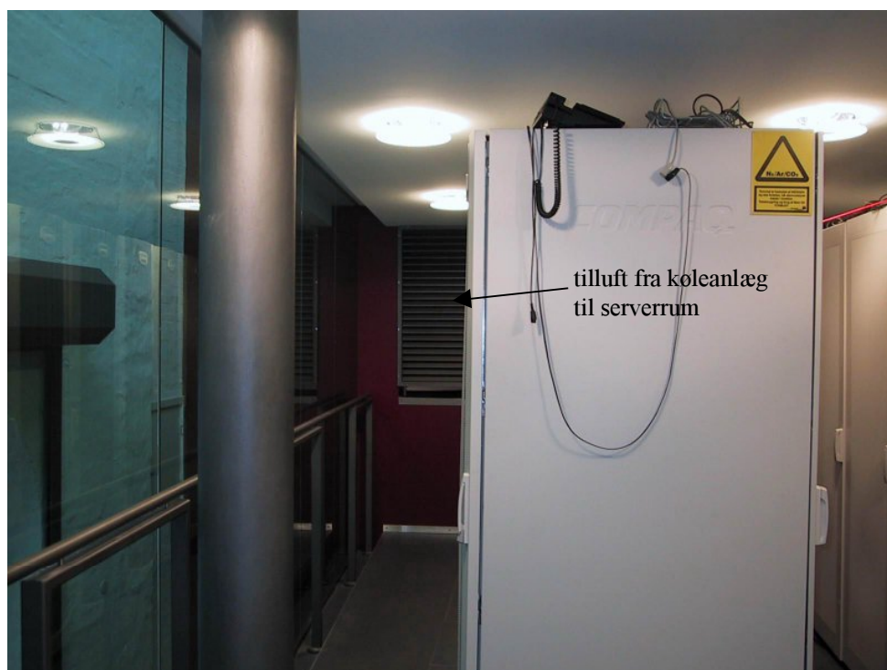
Figur 2.1.3. Den ene af køleanlæggenes indblæsning til serverrummet.
