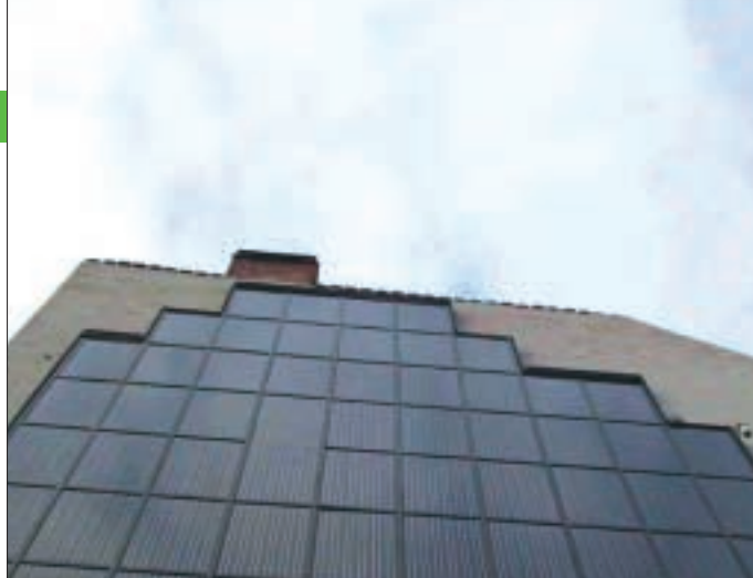
Figur 4. Toppen af solcellefeltet med Orbesen-ventiler til udluftning af spalten bag PV-panelerne, når lufttemperaturen her bliver for høj.
