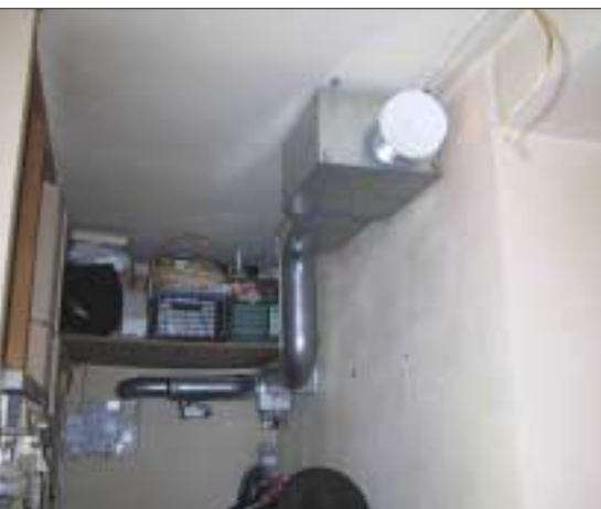
Figur 5. Ventilationsanlæg på tredje sal.
