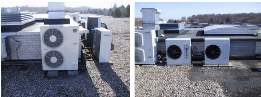
Figur 2. Køleanlæggets udedele placeret på taget.
