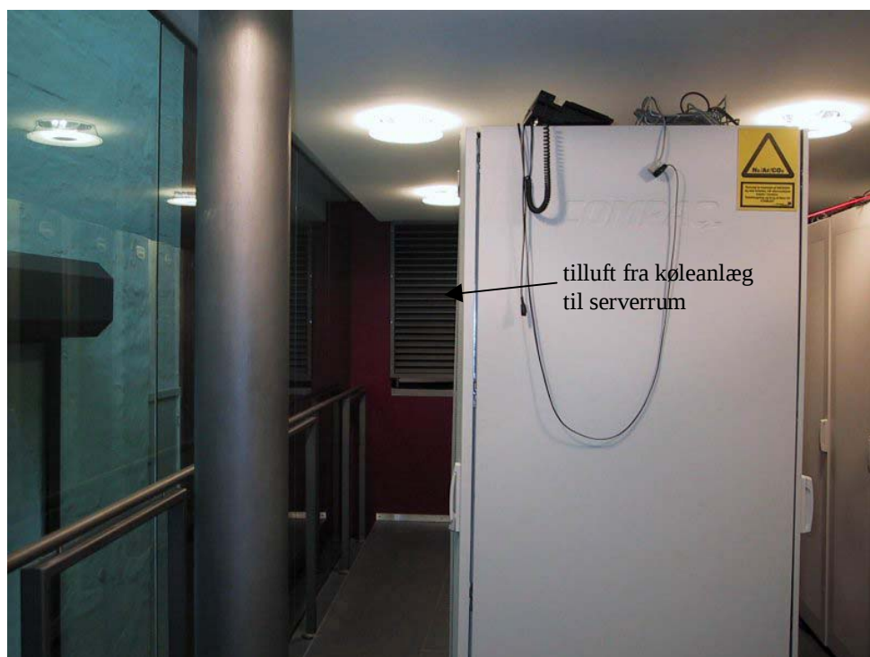
Figur 3. Den ene af køleanlæggenes indblæsning til serverrummet.
