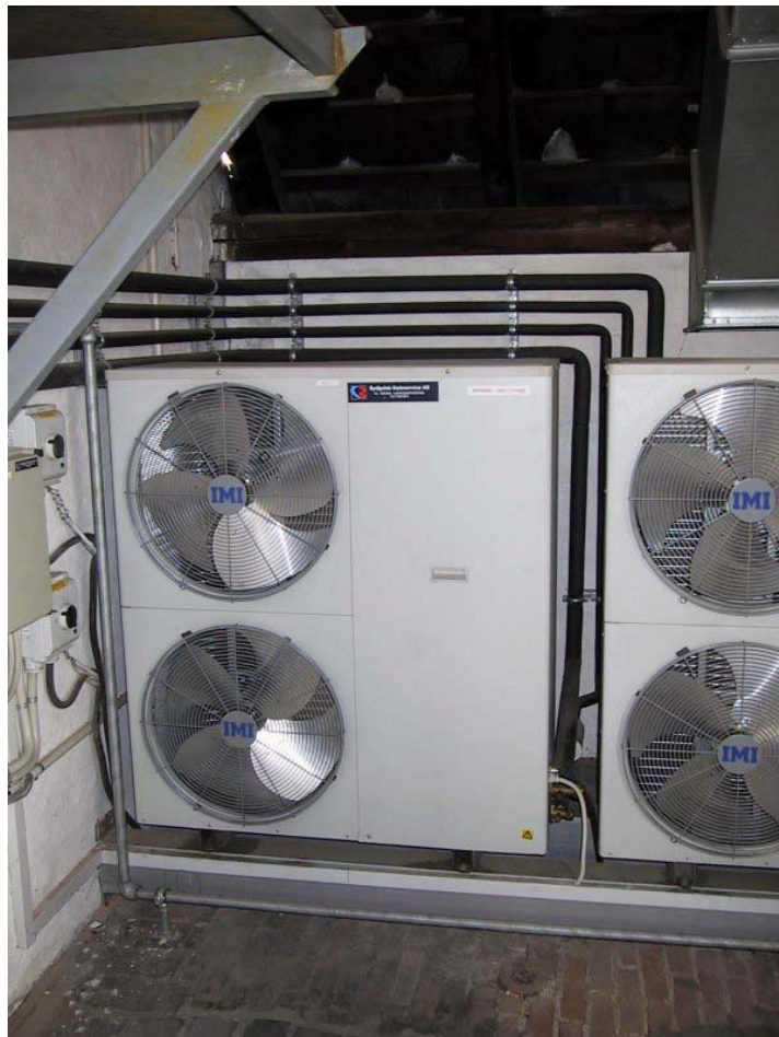
Figur 4. De to køleanlægs kondensatorer, der servicerer serverrummet.
