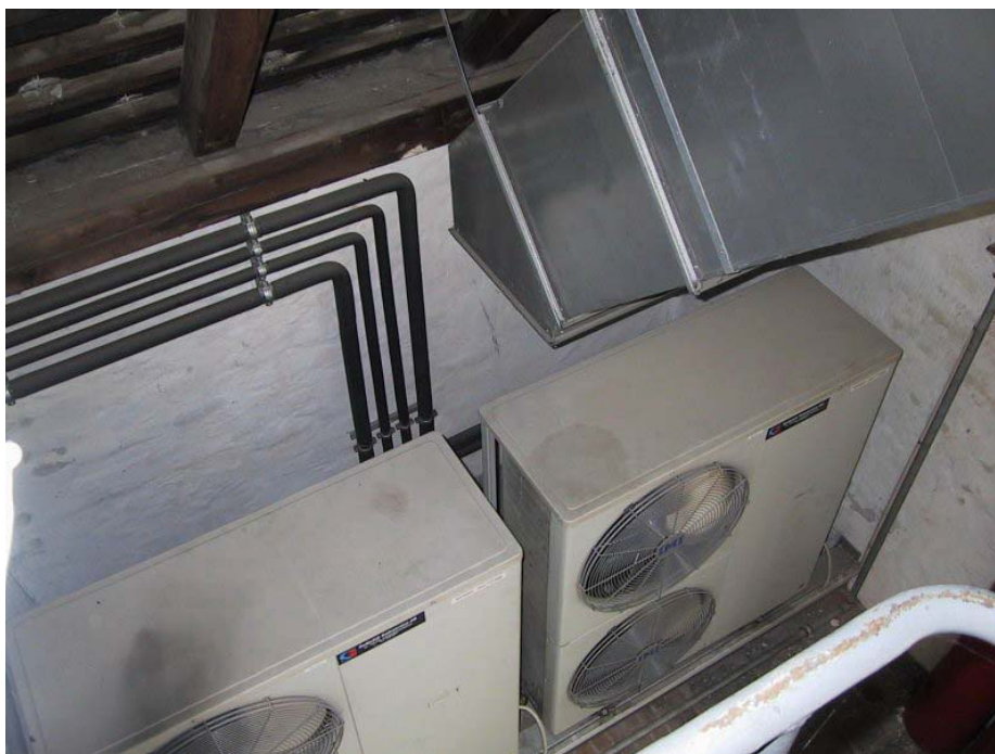
Figur 5. Køleanlæggenes kondensatorer og kanalen, der leder udeluft til kondensatorerne.
