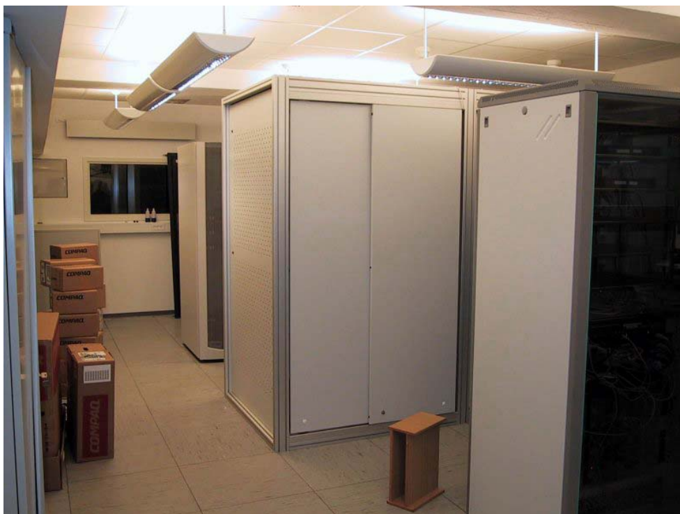
Figur 2. De tre rack med servere.
