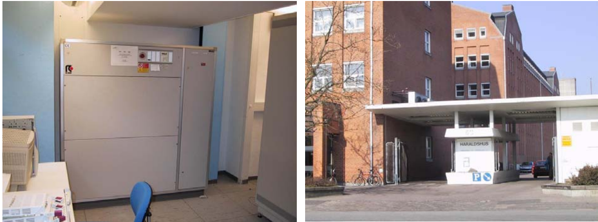
Figur 4. Det ene køleanlæg i serverrum og varmevekslerne udenfor bygningen.
