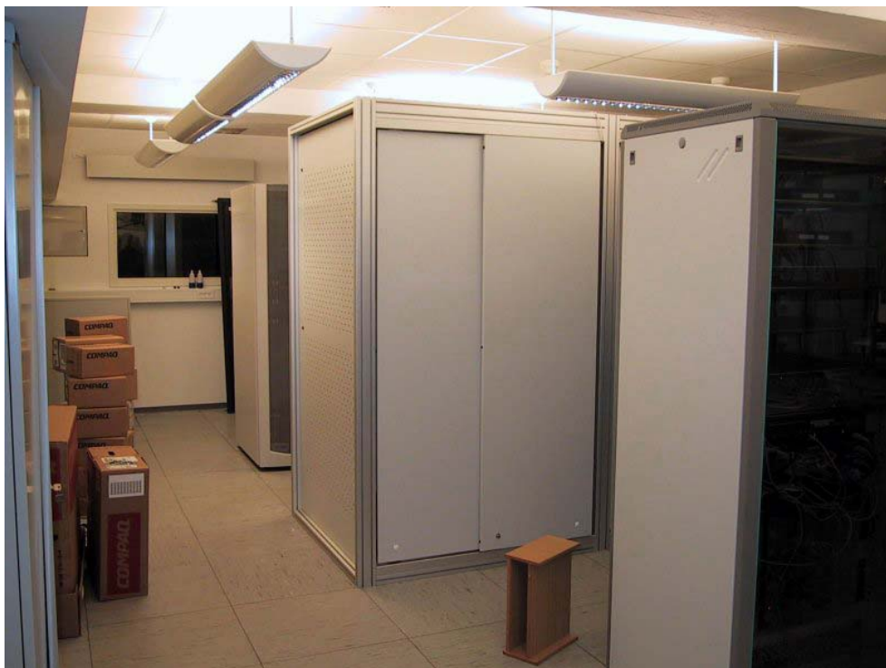
Figur 5: De tre rack med servere.
