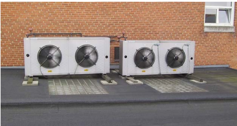
Figur 2: Billede af køleanlæggenes tørkølere på tag.
